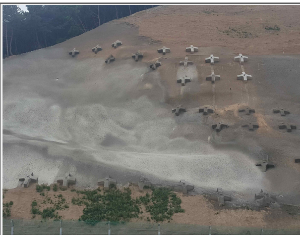
③ Sta.3+010~030부근(영천) 20m 소단 켜기파괴로 인한 보강흔적 보임
